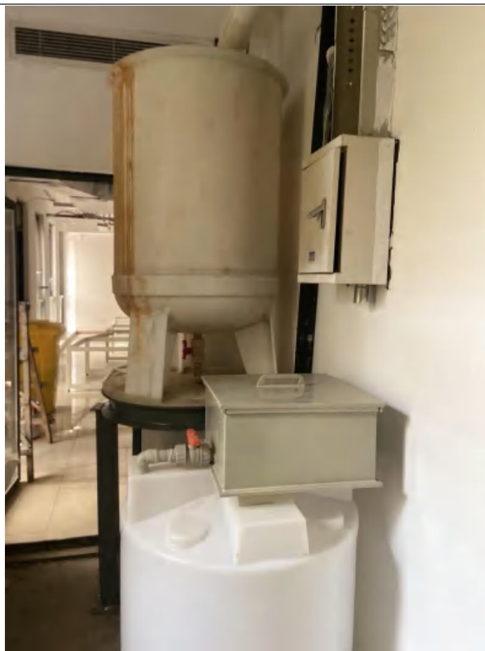
废水处理设施
