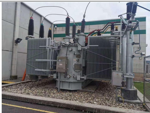
图 6-1 本期扩建 3#主变及主变下方油坑
