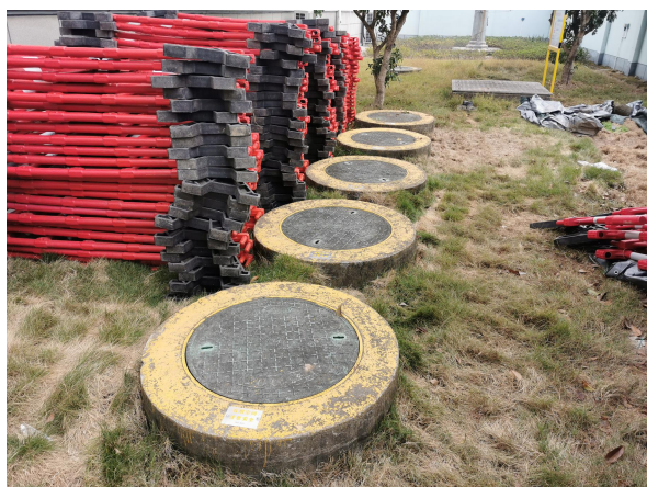
图 6-3 污水处理设施
