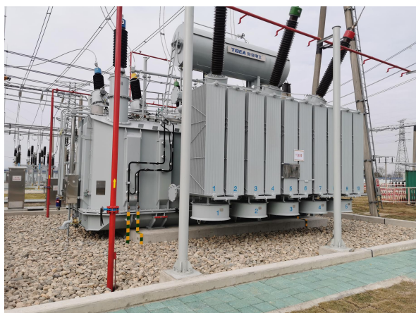
图 6-1 3#主变及下方事故油坑
