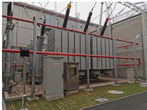
图 6-2 2#主变及下方油坑
