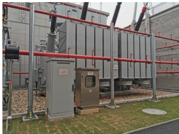
图 6-1 1#主变及下方油坑
