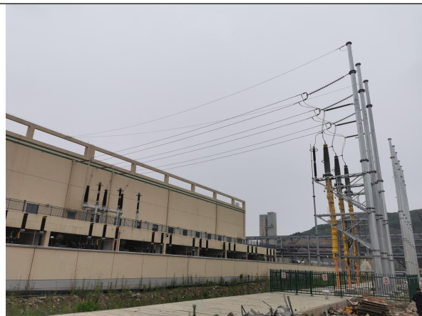
图 6-1 终端塔进变电站架空线路环境现状
