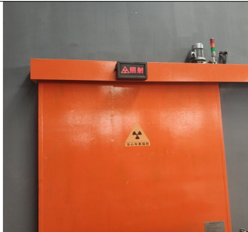
图 4-3 电离辐射警告标志和工作状态警示灯
