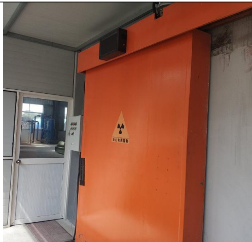
图 4-9 电离辐射警告标志和工作状态警示灯
