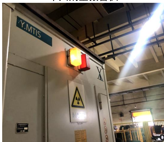
MG165 X 射线检测仪机房电离辐射标识及报警仪
