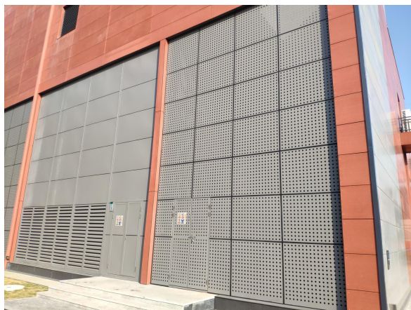
图 6-1 1#主变（油冷户内布置）
