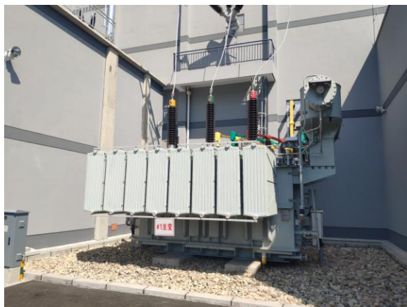
图 6-1 1#主变及下方油坑
