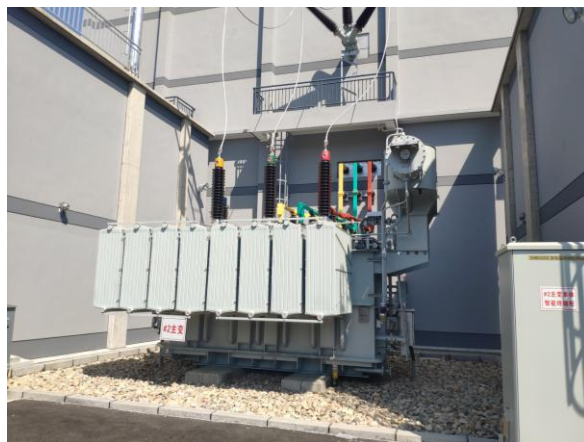
图 6-2 2#主变及下方油坑
