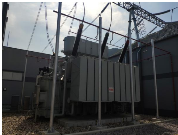
图 6-2 2#主变及下方油坑
