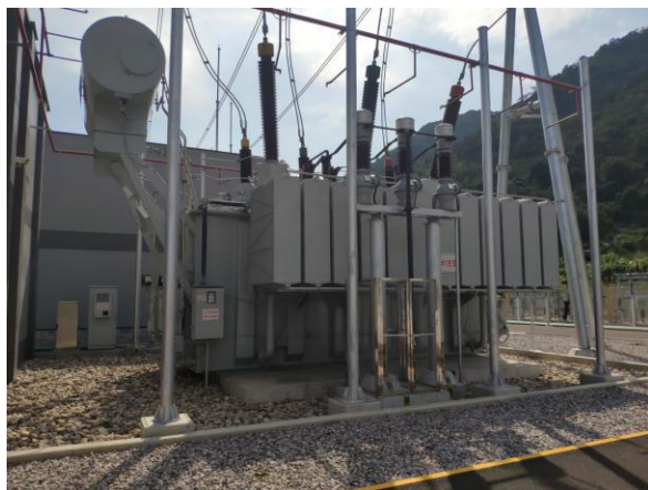
图 6-1 1#主变及下方油坑
