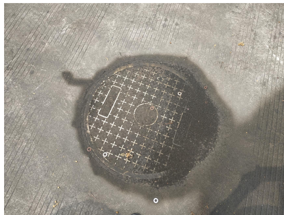
图 6-2 平湖变污水井
