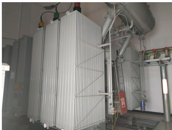
图 6-1 平湖变主变及下方油坑
