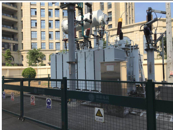
图 6-7 钱桥变主变及下方油坑
