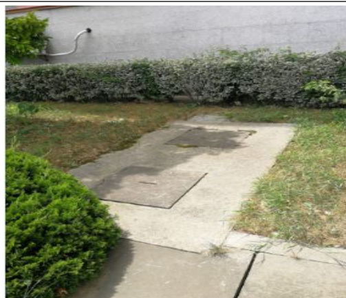
图 6-16 魏塘变事故油池
