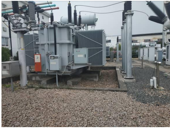
图 6-7 钱江变主变及下方油坑
