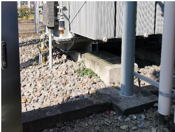
图 6-1 岱山变主变下方油坑
