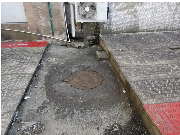
图 6-3 岱山变事故油池
