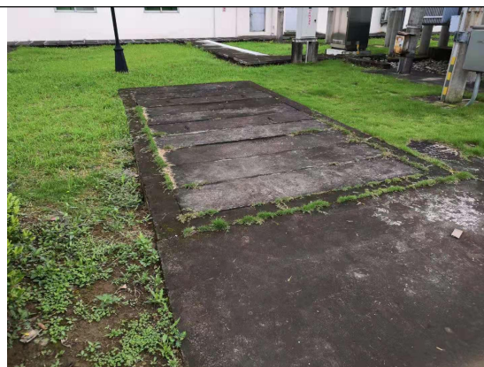
110kV 永宁变电站事故油池
