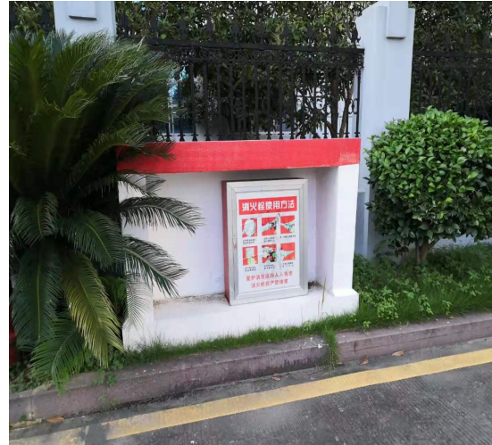
110kV 西范变电站主变消防室
