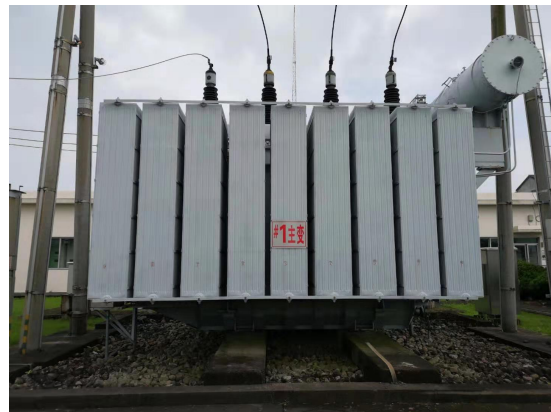
110kV 永宁变电站现有主变
