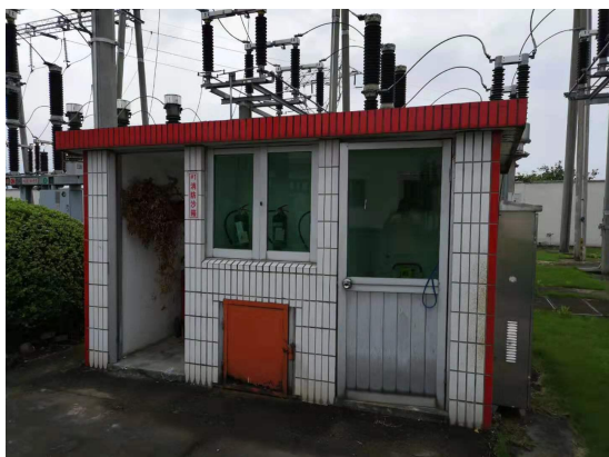
110kV 永宁变电站主变消防室
