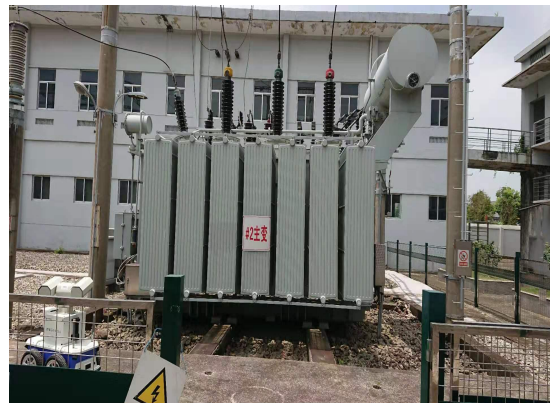
110kV 黄岩变电站现有主变
