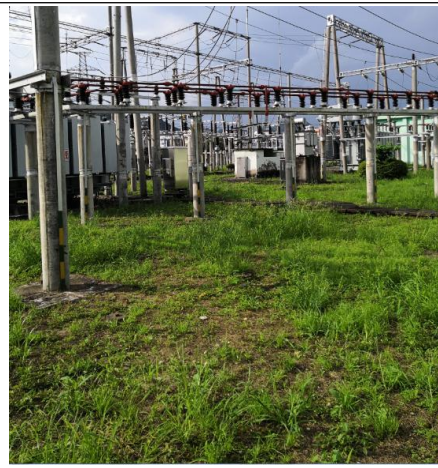
110kV 黄岩变电站站内绿化
