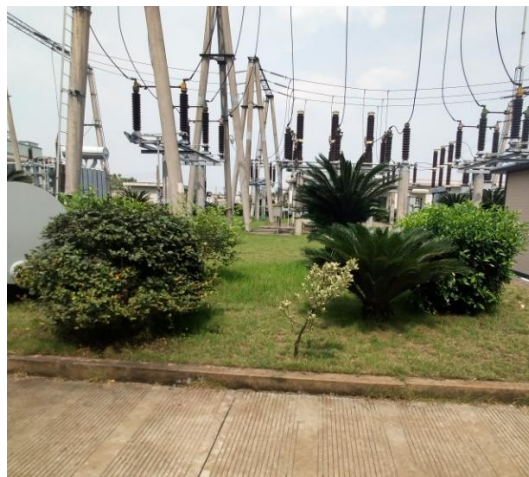
110kV 横街变电站站内绿化
