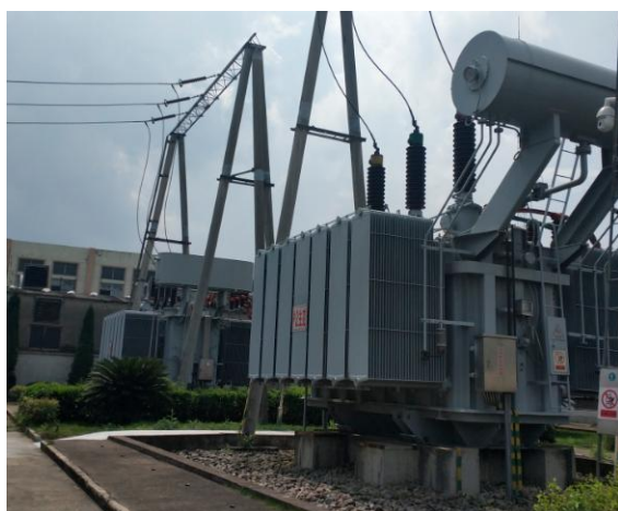
110kV 横街变电站主变 2 台
