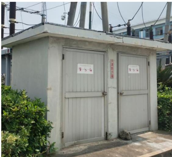
110kV 横街变电站主变消防室
