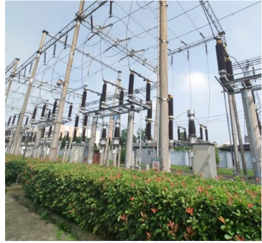
110kV 高升变电站站内绿化
