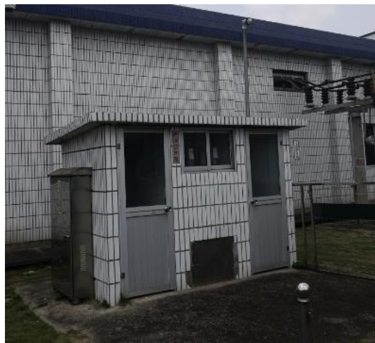
110kV 路东变电站主变消防室
