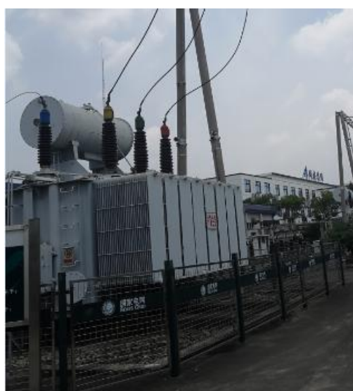
110kV 路东变电站主变 1
