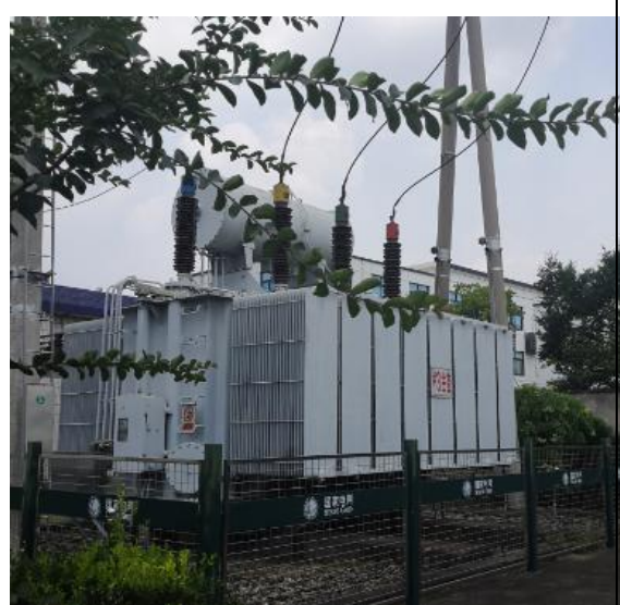
110kV 路东变电站主变 2
