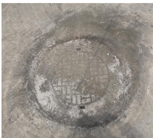
110kV 路东变电站污水处理设施
