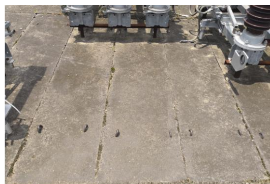
110kV 路东变电站事故油池
