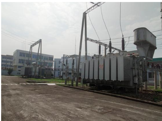
110kV 高升变电站主变 2 台
