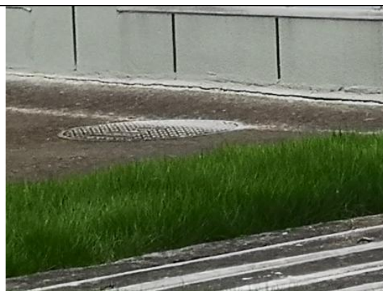
110kV 富仕变电站事故油池
