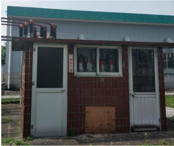
110kV 高升变电站主变消防室
