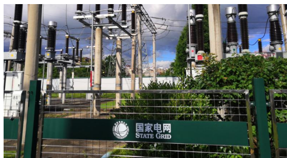
110kV 平镇变电站站内绿化及地面硬化
