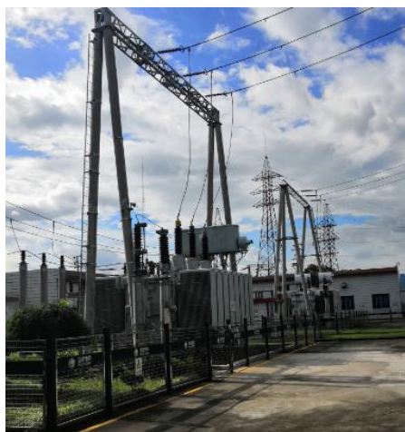
110kV 平镇变电站现有主变
