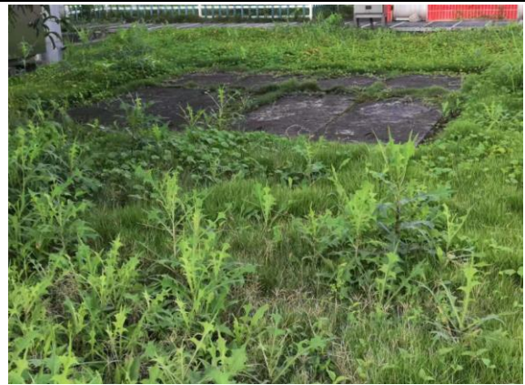
110kV 沙北变电站事故油池
