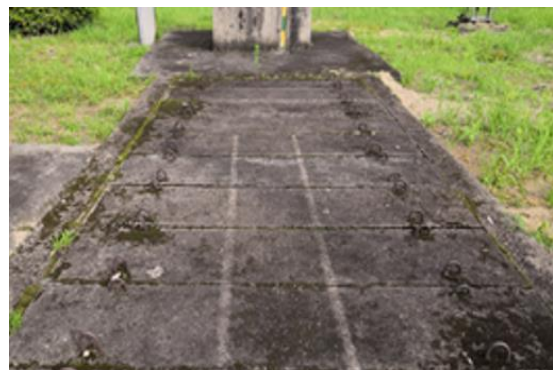
110kV 群辉变电站事故油池
