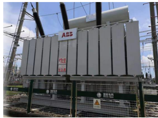
220kV 海门变电站现有主变
