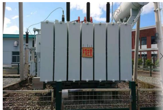
110kV 兆桥变电站现有主变
