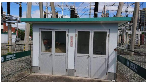
110kV 兆桥变电站主变消防室
