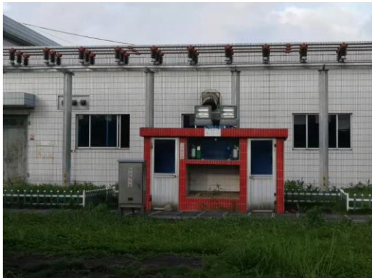
110kV 沙北变电站主变消防室
