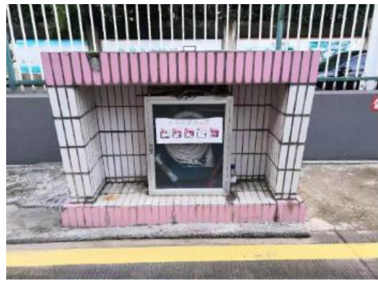
110kV 椒云变电站主变消防器具
