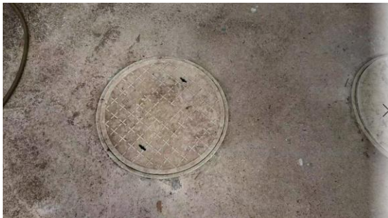
110kV 兆桥变电站污水处理设施
