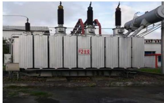
110kV 沙北变电站现有主变
