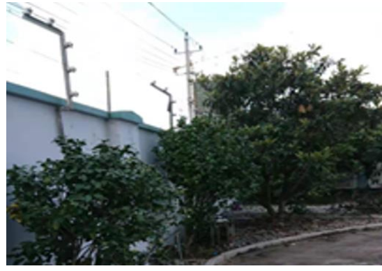
110kV 群辉变电站站内绿化
