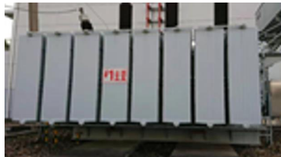
110kV 群辉变电站现有主变
