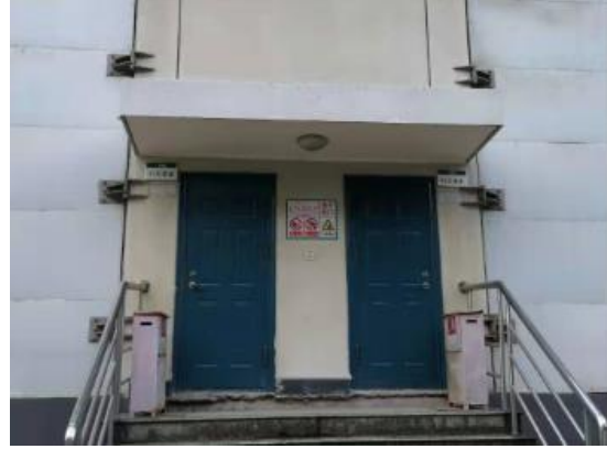
110kV 椒云变电站现有主变
