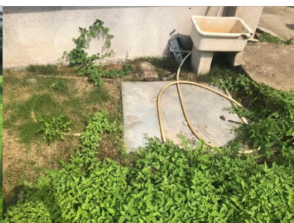
污水处理设施
