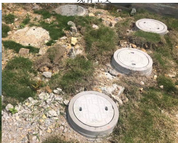
污水处理设施
