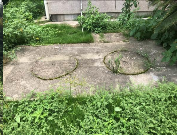
污水处理设施
