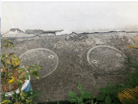
污水处理设施
