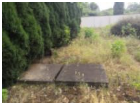
110kV 兰溪变电站事故油池
