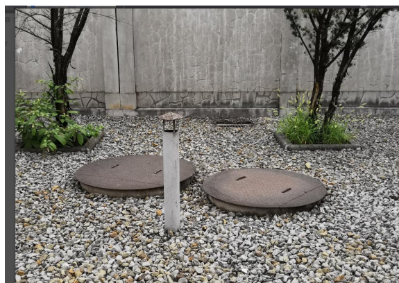
110kV 龚塘变电站事故油池
