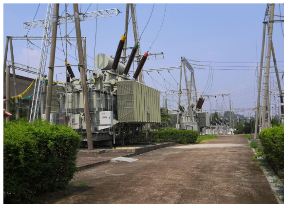
220kV 云山变电站现有主变
