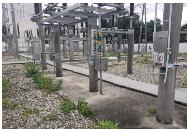
110kV 中洲变电站站内绿化
