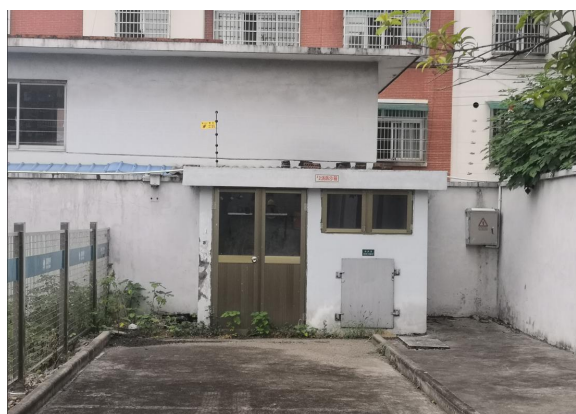
110kV 中洲变电站主变消防室
