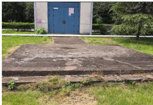
220kV 云山变电站事故油池
