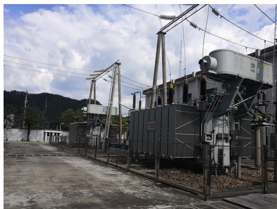
110kV 六洞山变电站现有主变
