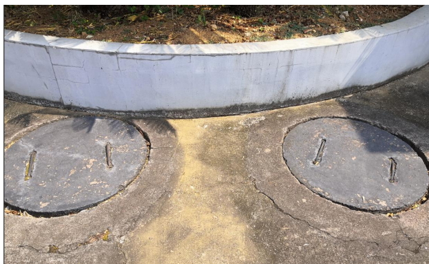
220kV 云山变电站污水处理设施
