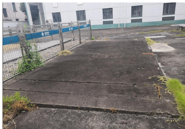
110kV 中洲变电站事故油池
