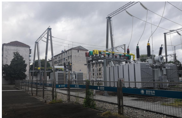
110kV 中洲变电站现有主变
