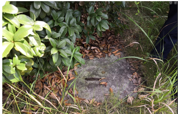
110kV 莲花变电站事故油池
