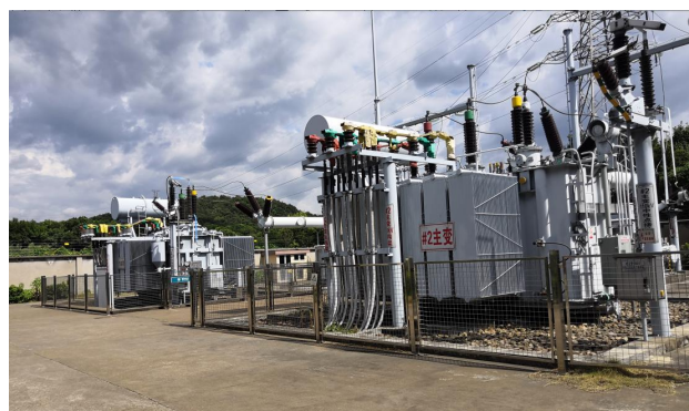
110kV 莲花变电站现有主变
