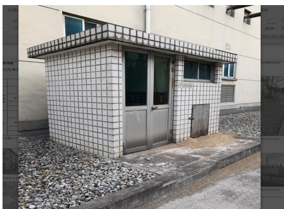
110kV 龚塘变电站主变消防室
