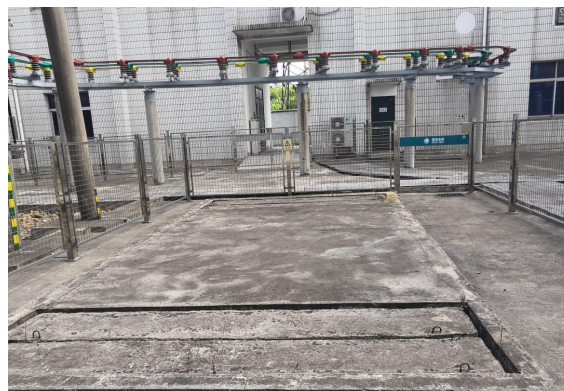
110kV 六洞山变电站事故油池
