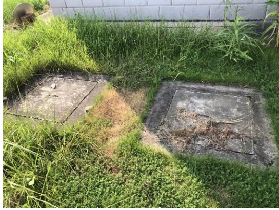
污水处理设施
