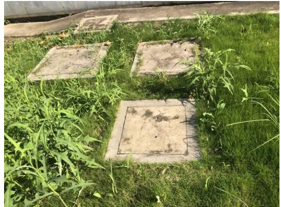
污水处理设施
