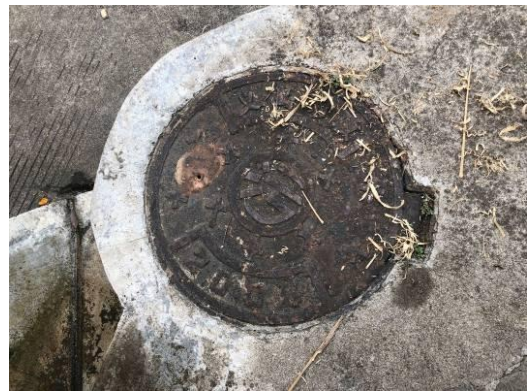
污水处理设施
