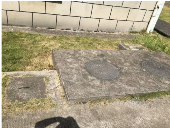
污水处理设施
