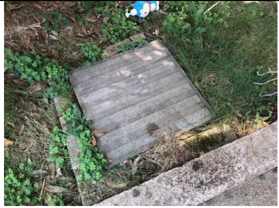
污水处理设施
