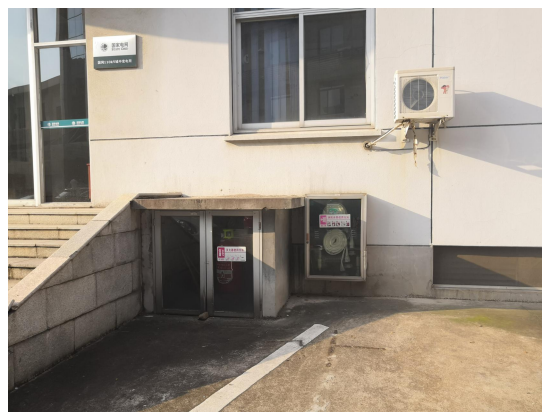
110kV 城中变电站主变消防室
