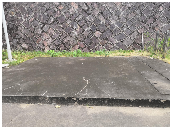
110kV 罗店变电站事故油池
