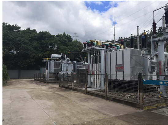
110kV 罗店变电站现有主变
