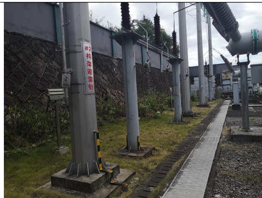
110kV 罗店变电站站内绿化
