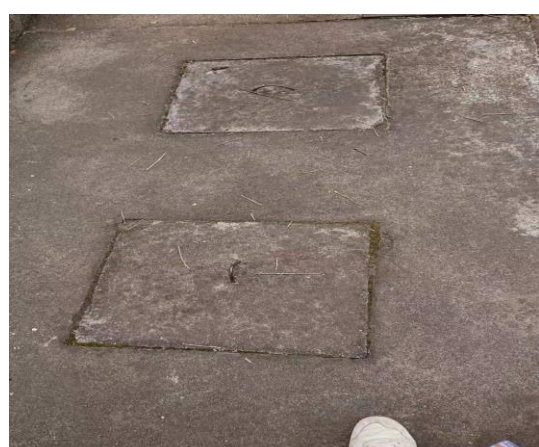
110kV 东皋变电站事故油池
