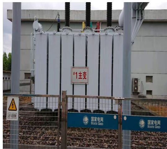
110kV 东皋变电站现有主变
