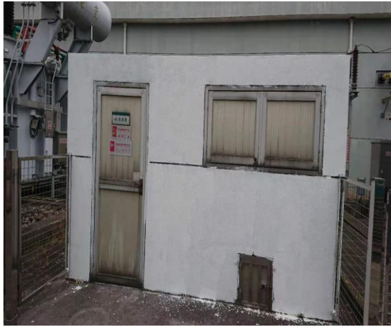
110kV 东皋变电站主变消防室
