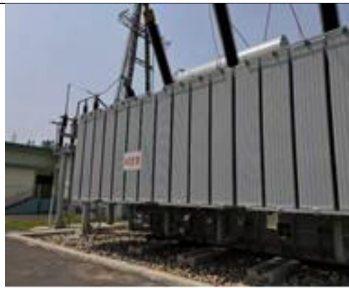
220kV 方岩变电站现有主变
