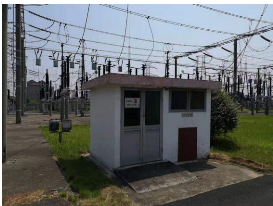
220kV 方岩变电站主变消防室
