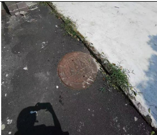
110kV 武义变电站污水处理设施
