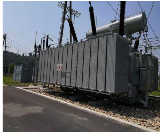
110kV 武义变电站现有主变
