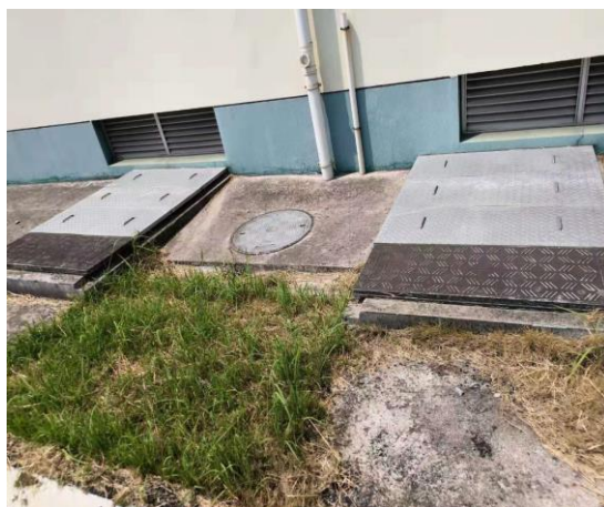
110kV 武义变电站事故油池
