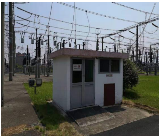
110kV 武义变电站主变消防箱
