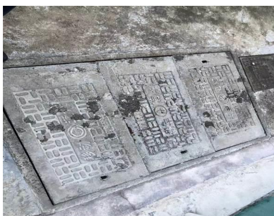
污水处理设施
