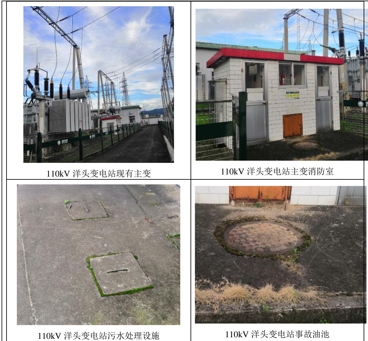
图 3-1 110kV 洋头变电站现状
